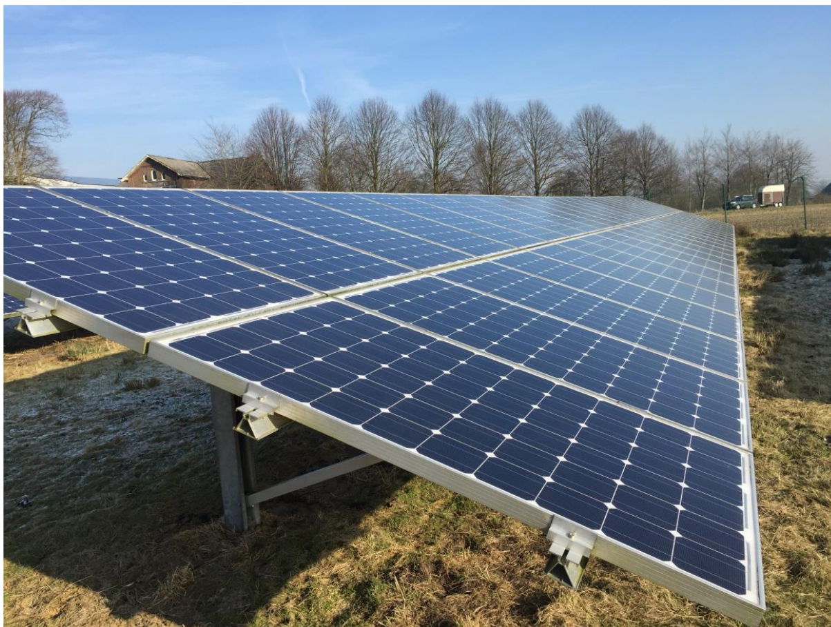
Abbildung 11: Beispiel einer PV-Freiflächenanlage mit 2 senkrechten Modulreihen
